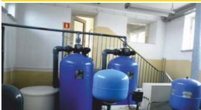
Instalacja redukcji azotanów w Brzezinkach
